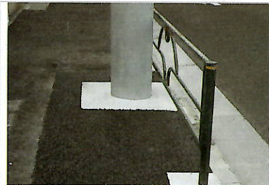
水道管工事後の再舗装（本復旧）に「ゴールドパッチ」を使用した。プラント加熱合材を使用する既往のアスファルト舗装と比較しても遜色のない仕上がりとなっている
